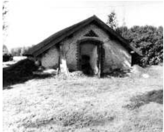
XX a. pirmajai pusei būdingas iš baltų (silikatinų) plytų sumūrytas rūsys Pagėgių apylinkėse – raudonų plytų dekoras, raudonomis keraminėmis čerpėmis dengtas dvišlaitis stogas // Martyno Purvino nuotr. (1991 m.)
