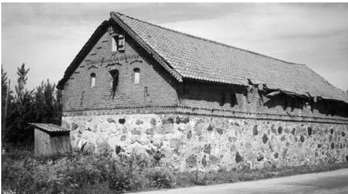
XX a. pr. būdingas iš akmens riedulių ir plytų sumūrytas vidutinio ūkininko tvartas Įsruties apylinkėse – raudonplytis ertikis ir dekoruoti stogo skydai, raudonų keraminių čerpių stogas, drožinėtos medinės vėjalentės // Martyno Purvino nuotr. (1995 m.)
